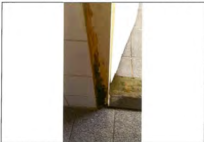
rottende stijlen in de douche ruimte van de berging.
