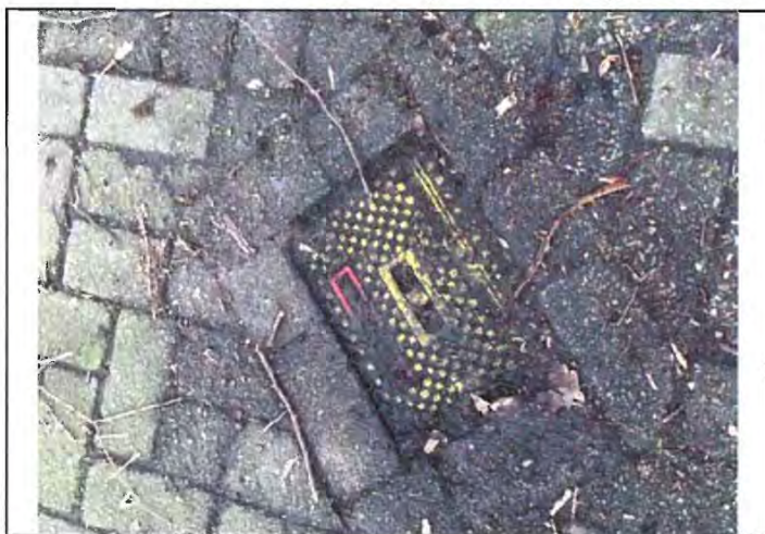
Aansluitpunt voor water /brandweer.
