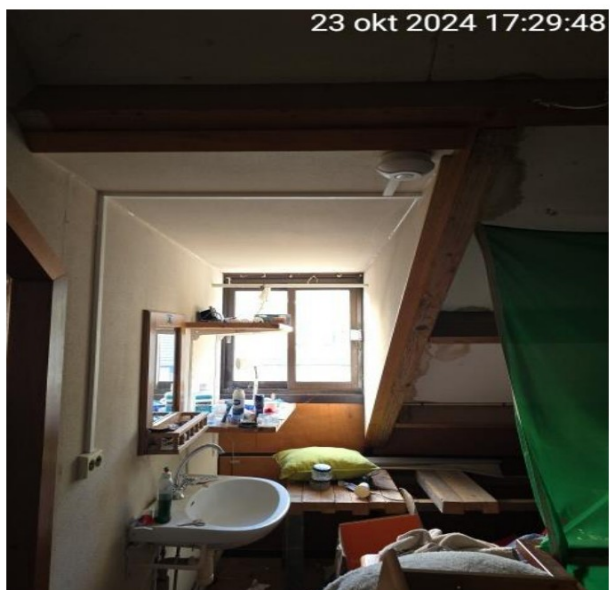
2 e / overloop-2 / vzv rookmelder / voldoet.
