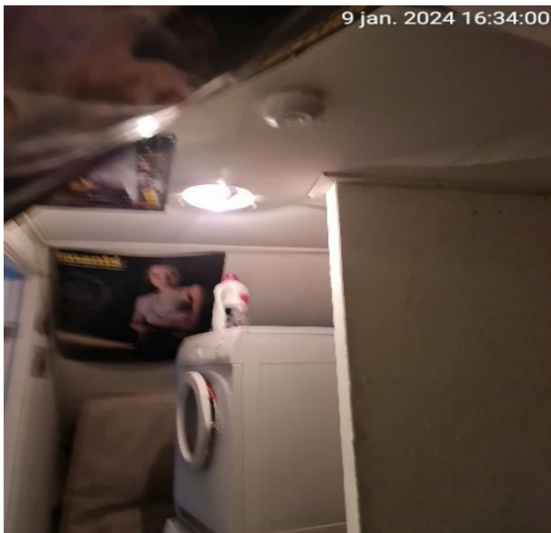
2 e / overloop-2 vzv rookmelder / voldoet
