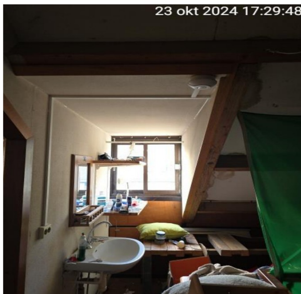
2 e / overloop-2 / vzv rookmelder / voldoet.
