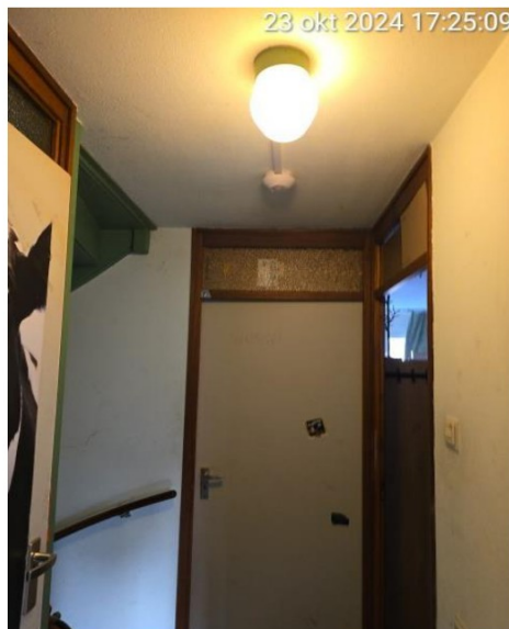
1 e / overloop-1 / vzw rookmelder / voldoet.
