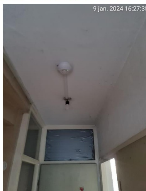
1 e / overloop-1 / vzw rookmelder / voldoet.
