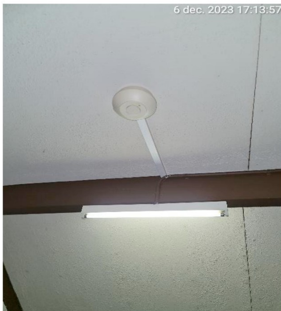
2 e / overloop-2 / vzv rookmelder / voldoet.
