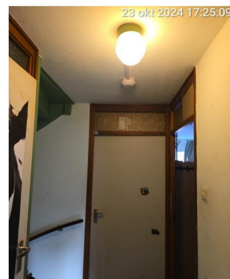
1 e / overloop-1 / vzw rookmelder / voldoet.
